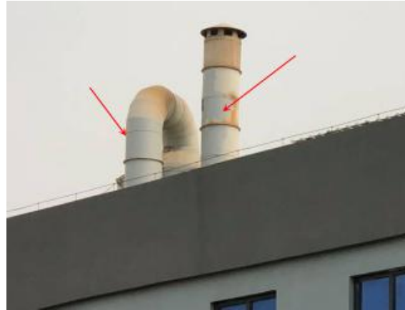
酸雾吸收塔+15m 高排气筒
