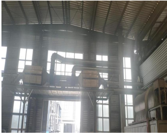
达克罗生产车间环保设施：干式过滤器+光氧 等离子一体机
